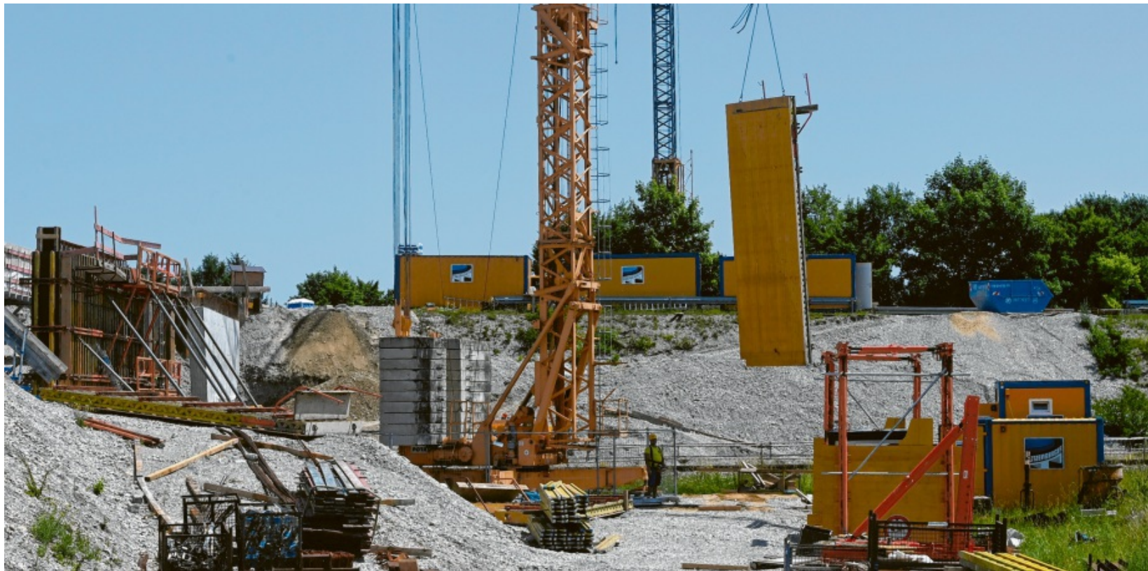
Die Bauarbeiten an der Kreisstraße A30 dauern länger als geplant. Foto: Marcus Merk
