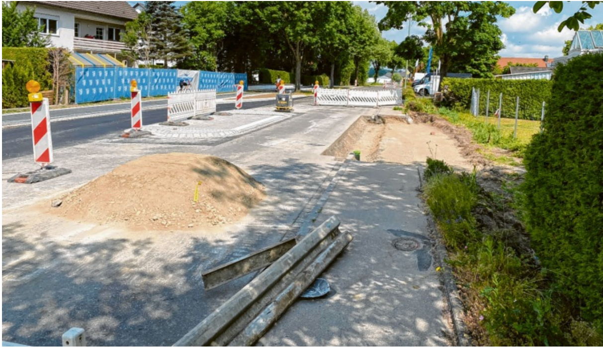
Der Bau des neuen Geh- und Radwegs mit barrierefreien Bushaltestellen und Querungshilfen über die Hauptstraße ist inzwischen in den letzten Zügen. In wenigen Wochen ist das Projekt abgeschlossen. Foto: Tobias Kunz
